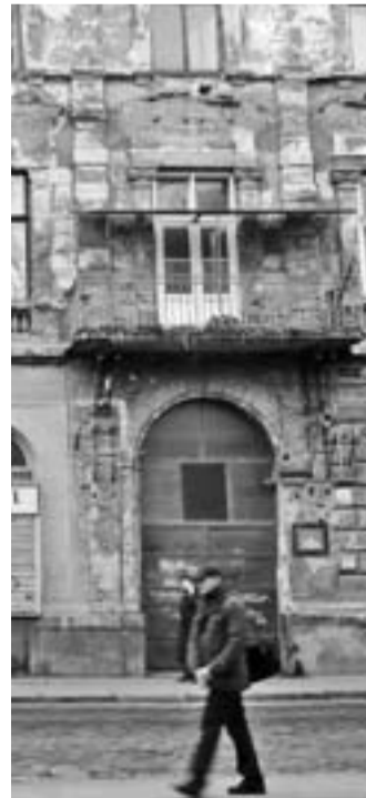
A lakásállomány felújításra vár
